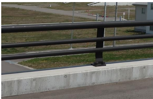
たわみ性防護柵（高さ 750 mm）
