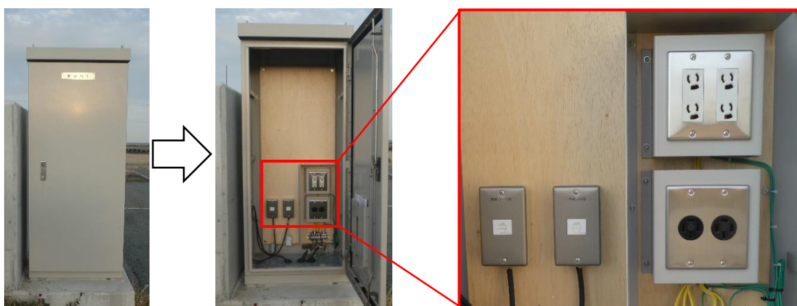
LAN コンセント盤
