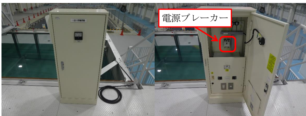
小型水槽電源盤（外観）
